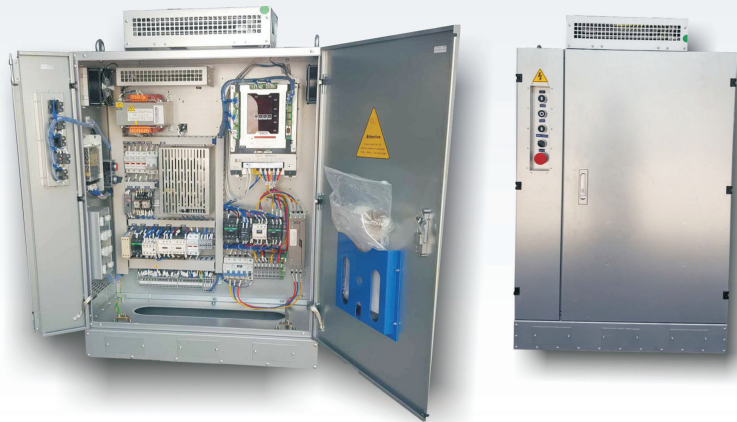
TỦ ĐIỆN STEP - THAILAND
